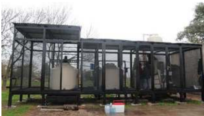
Figura 14: Equipos de purificación de agua desarrollados por la UNLP.
