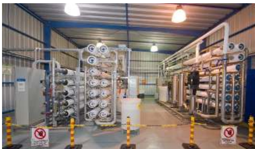
Figura 10: Planta de ósmosis inversa instalada en Venado Tuerto (Santa Fe).
