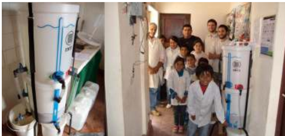
Figura 12: Dispositivo diseñado por personal del INTI para la remoción de As instalado en escuelas rurales de la provincia de Chaco.
